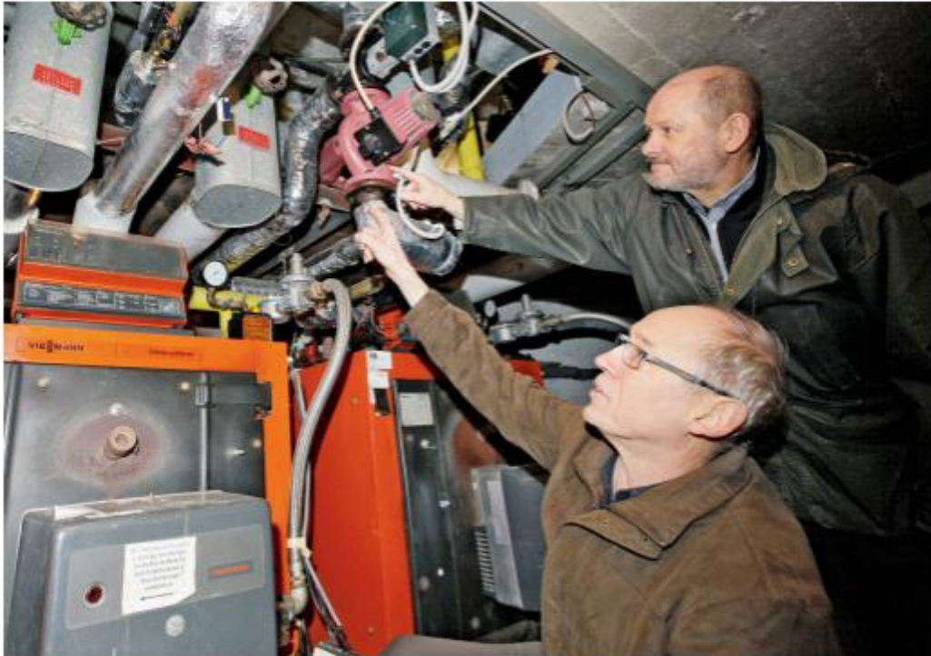
Inspektion: Gutachter Ernst Merkschien (hinten) und Benedikt Siepe betrachten die Heizungsanlage der Kusselbergschule.
